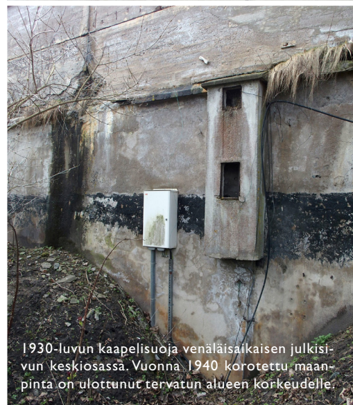
Vuoden 1940 lisäkate on huonossa kunnossa vedenheittäjän ja liikuntasauojen kohdalta.
